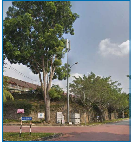
Monopole Jalan Damai Budi, Kuala Lumpur
