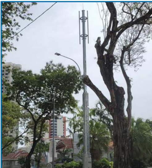
5G Monopole Persiaran Gurney, Pulau Pinang
