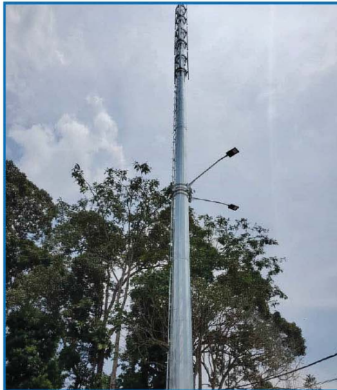
Monopole Pengkalan Hulu, Perak
